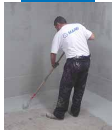
Mapelastic Foundation steso a rullo in un intervento di impermeabilizzazione in contropinta
