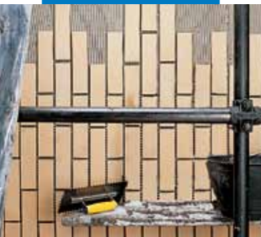
Posa a parete in esterno
